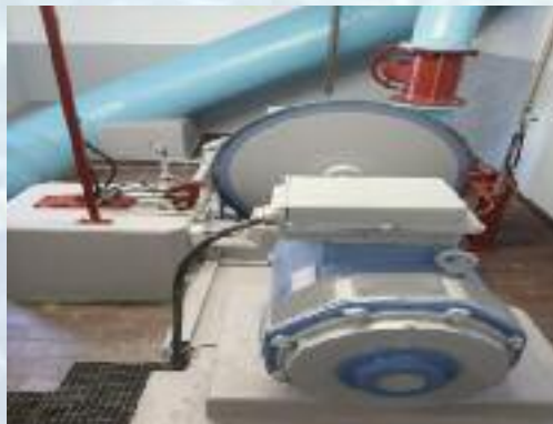
Kleine Turbine Daxenberg, 60 kW Leistung
